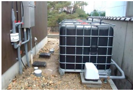
↑3tの雨水タンクで洗濯、トイレ、散水に（草津市A邸）
